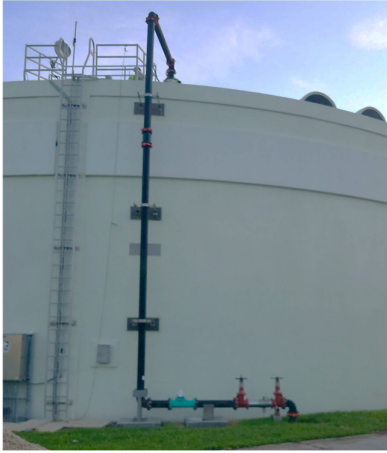
New fill piping
